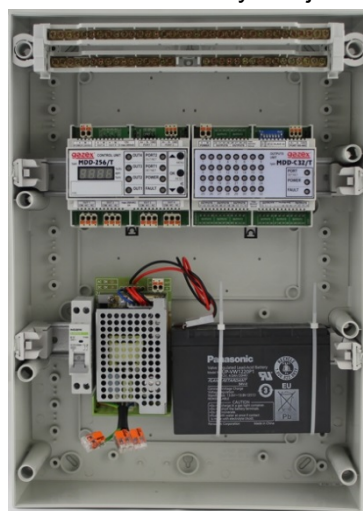
Przykładowy montaż w rozdzielni elektrycznej
